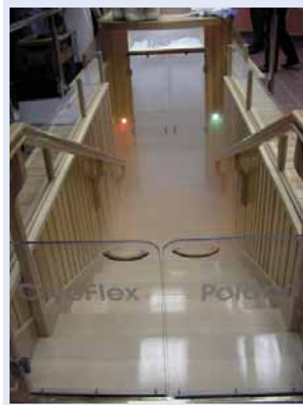
Obrázek 4. Kryokomora využívající efektu tzv. akumulace chladu
